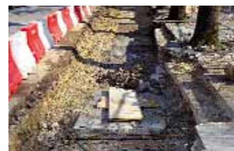
■ Sostituzione tombinatura obsoleta sulla roggia Lama lungo via Manzoni, di fronte al municipio, a Carmignano;
