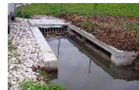
■ Costruzione nuovo manufatto di sfioro sullo scolo Torresino a protezione della tombinatura in via San Gaetano a Marostica;
