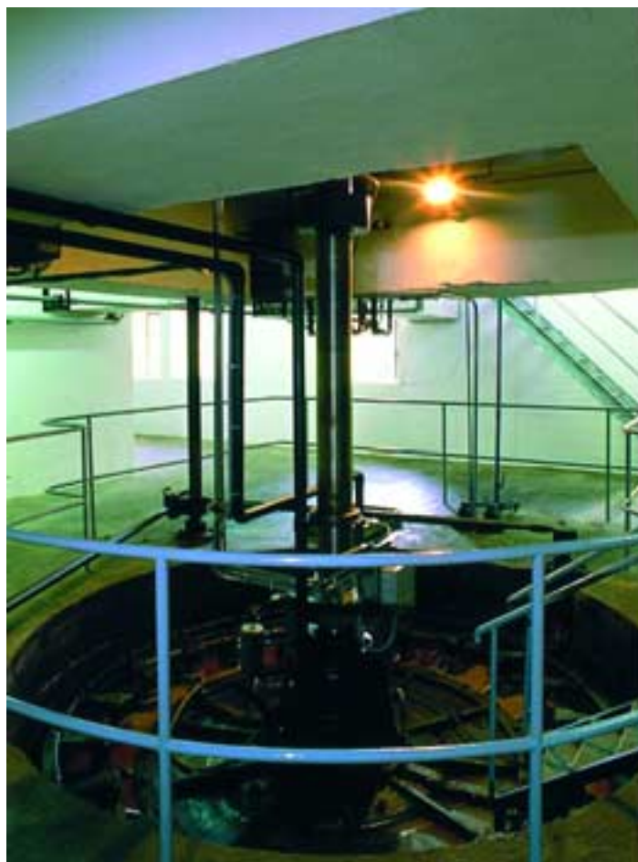
figura 56 ————— Turbina centrale S. Lazzaro, 1° salto
