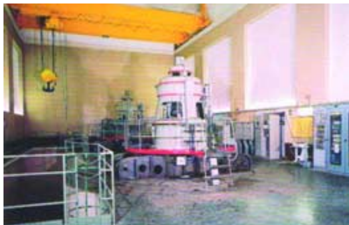
figura 46 Centrale Cavilla (Corlo-Brenta)
