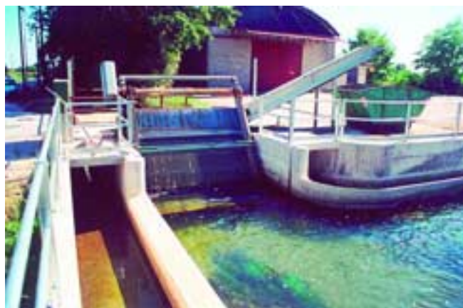
figura 9 ————— Sgrigliatore sulla Roggia Cappella
