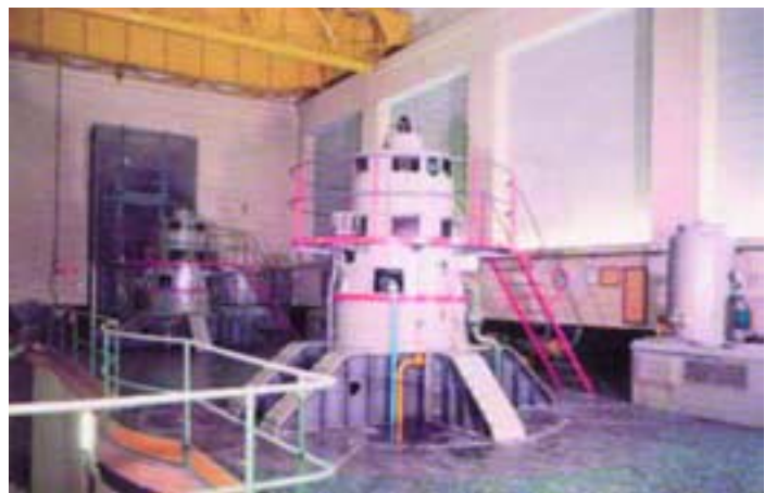
figura 44 Centrale di Arsìe (Senaiga-Corlo)
