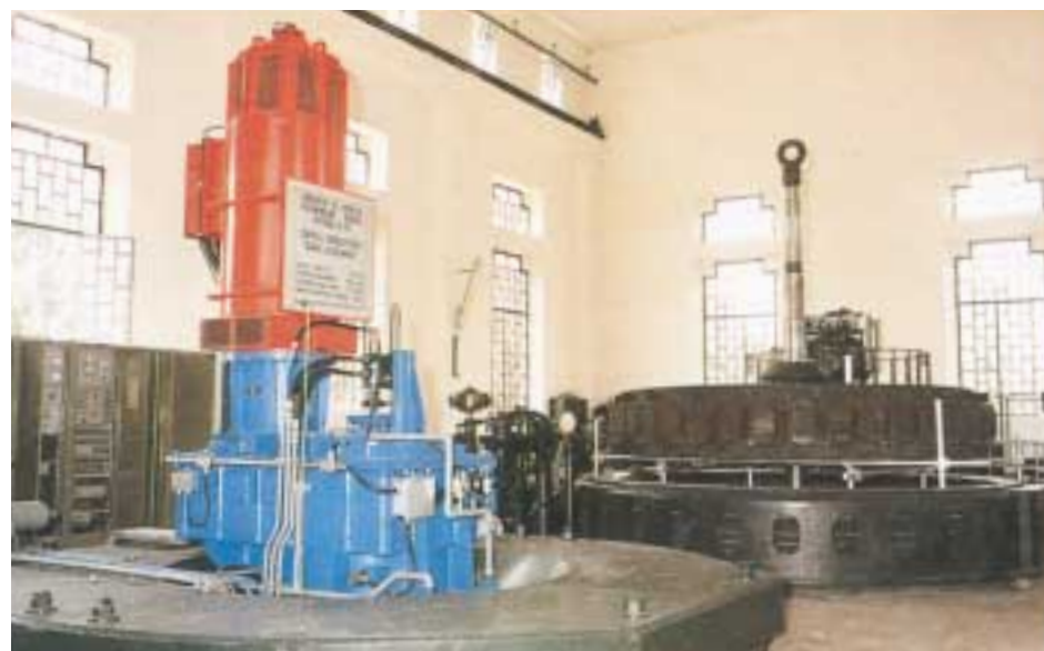
Turbine della centrale di San Lazzaro
