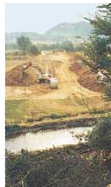
Scolmatore roggia Cornara a Bassano
