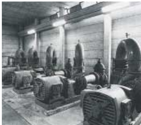
Impianto di pompaggio di Camisano
